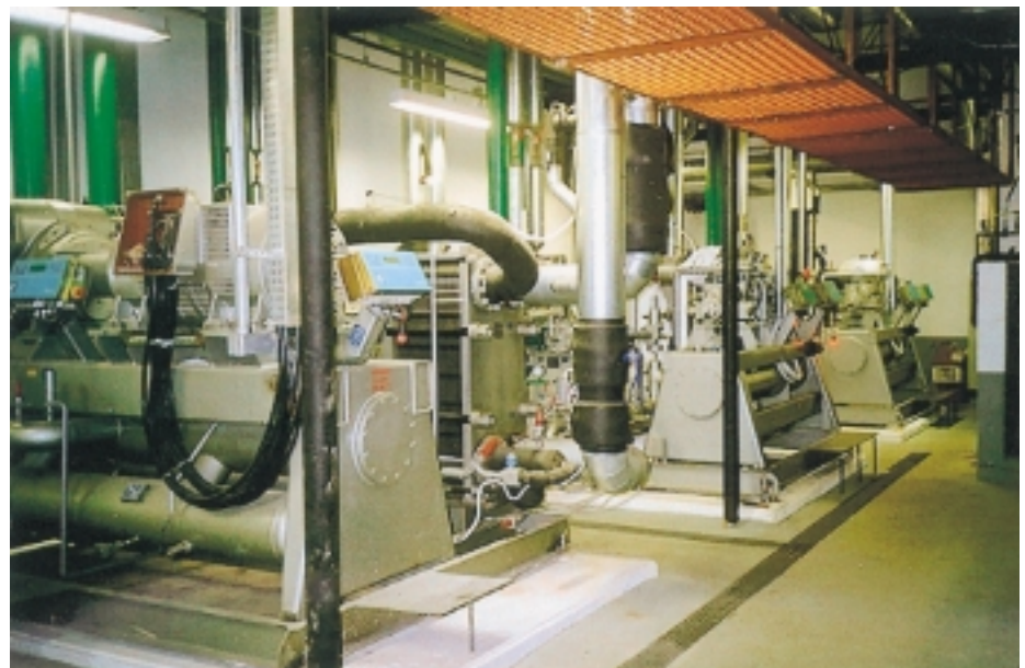
Bild 3 Zentrale Kälteanlage für Supermärkte bis 10 000 m 2 Verkaufsfläche. NH 3 -Flüssigkeitskältsätze mit Schraubenverdichtern für Kühlwasser/Klimaanlage, TYFOXIT® 1.20 und PG/Wasser (von links nach rechts)
